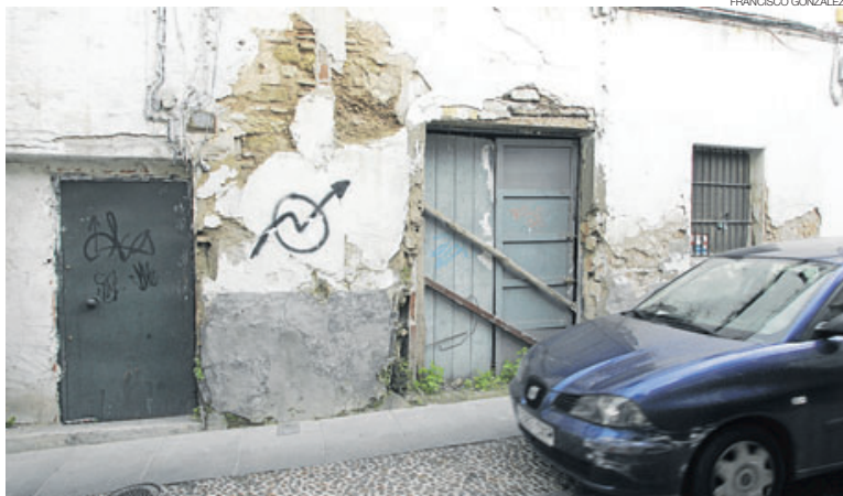
► Fachada de una vivienda muy deteriorada en el caso antiguo de Córdoba.
